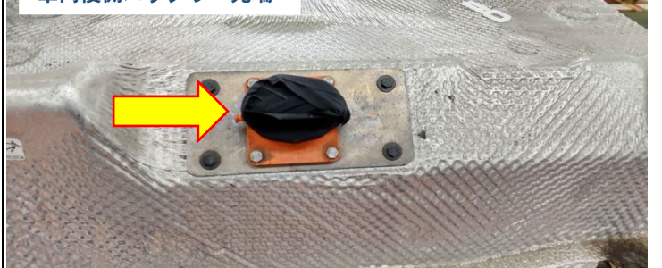
車両後側バッテリー先端
