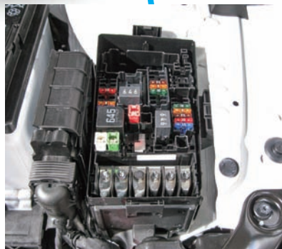
▶ ヒューズホルダー SA/SB (モータールーム左側)
